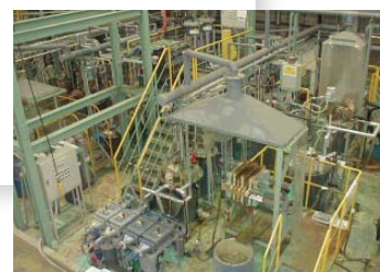
湿式銅製錬パイロット試験設備
