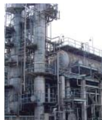
硫黄回収排煙脱硫装置
