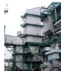
排煙脱硫装置
